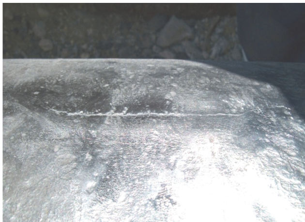
Obr. 13.1 – Detail zjištěného defektu
