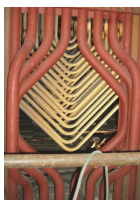
Obr. 13 Kotlové trubky, průřez
