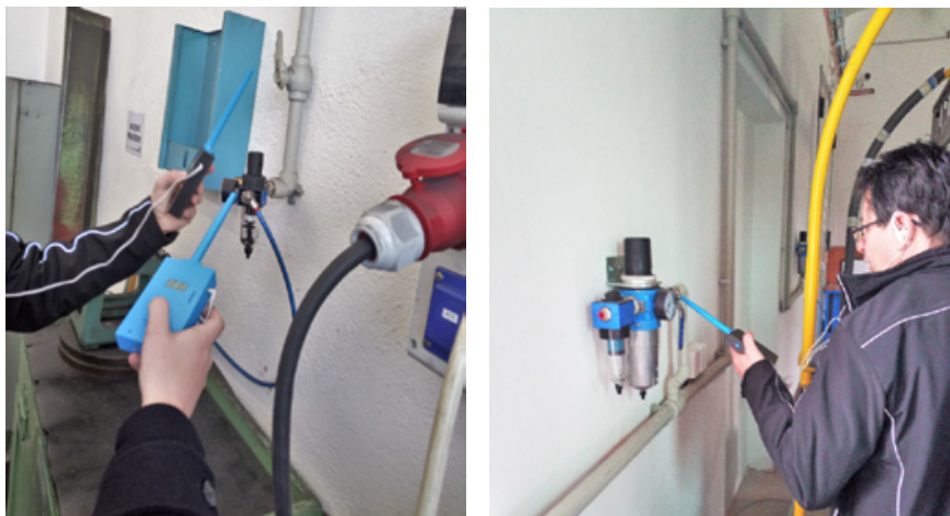
Obr. 7 Měření úniků vzduchových rozvodů pomocí bezkontaktního detektoru AE Fig. 7 Measurement of air distribution leaks using non-contact AE detector
