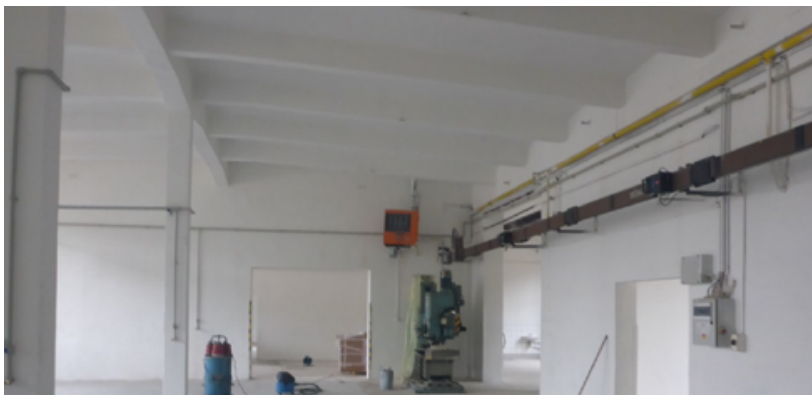
Obr. 3 Vzduchové rozvody v nově zrekonstruované dílně
